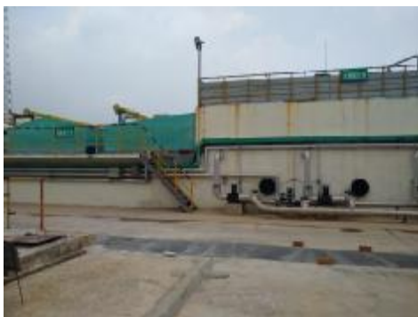
厂区污水处理站
