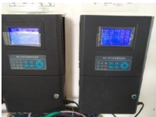
可燃气体监控系统
