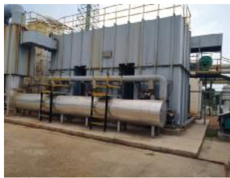
RTO 废气处理装置
