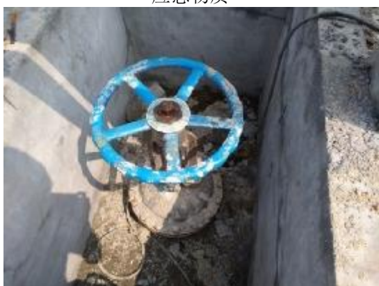
罐区雨污切换装置
