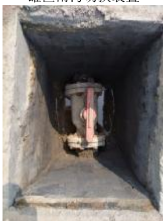
事故水池雨污切换阀门
