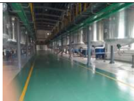
DL-高丙氨酸车间内部
