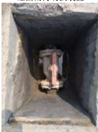
事故水池雨污切换阀门
