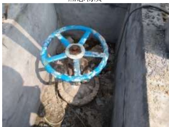
罐区雨污切换装置
