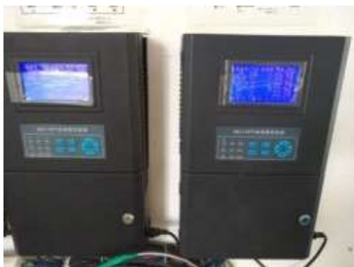
可燃气体监控系统
